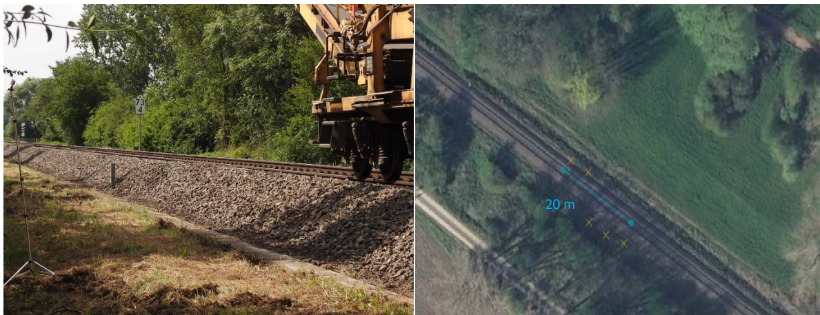
Abbildung 8: Kamerainstallation am 05.07.2017 neben dem Gleis. Kartengrundlage: Landesamt für Vermessung und Geoinformation Sachsen-Anhalt (LVermGeo)
