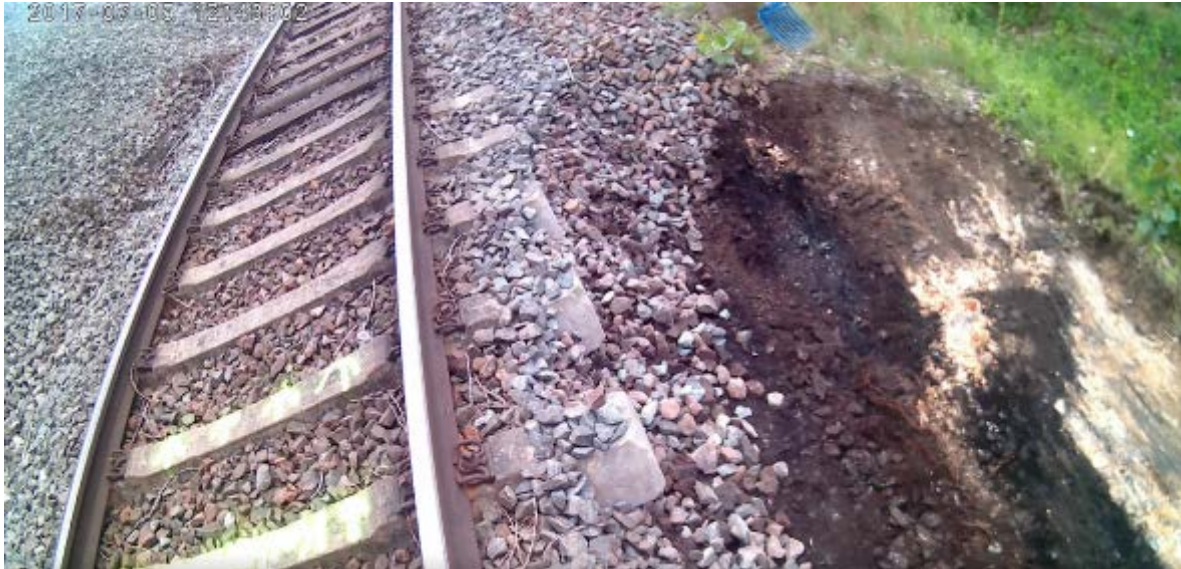
Abbildung 1: Ansicht vom Zwei-Wege-Bagger während der Schotterabtragung bahnlinks, Strecken-km 74,5. Das verzerrte Bild ergibt sich aus dem Zusammenspiel von Weitwinkel und seitlicher Anbringung der Kamera.
